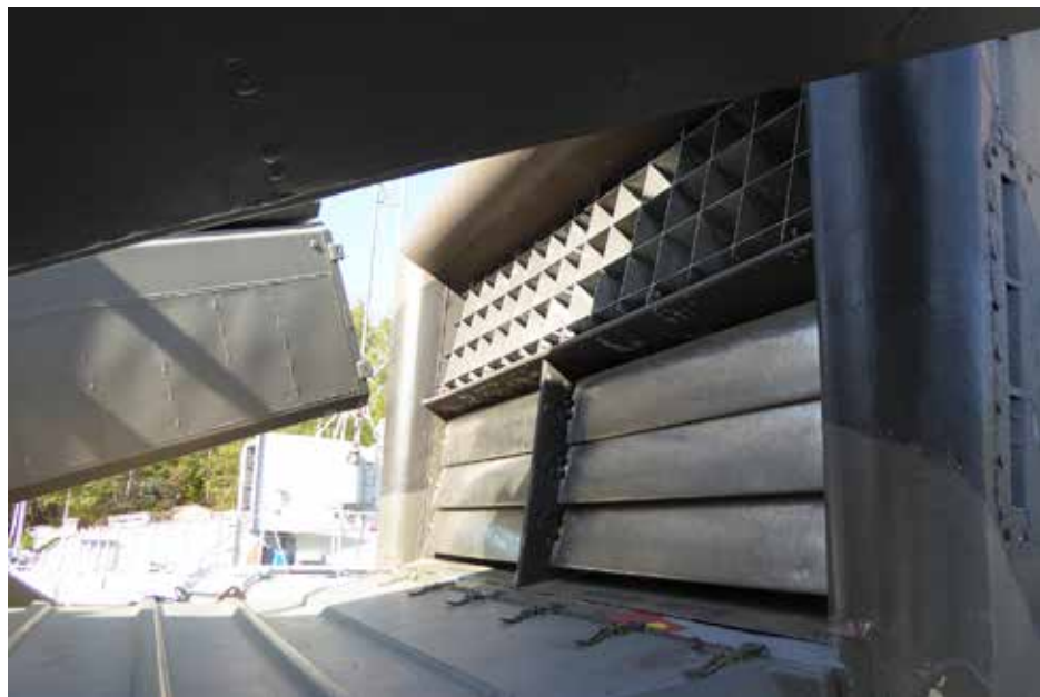
Luftindtag til turbinerne, 100 kubikmeter i sekundet.
